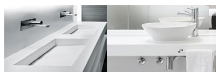
Lavatório encastrado na bancada em micromármore tipo "HI MAC- LG" na cor branco
