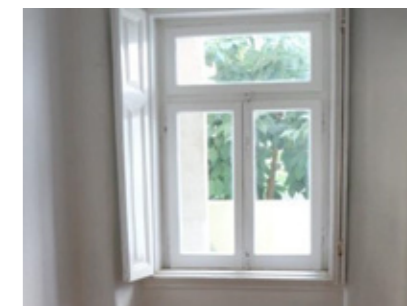
Reabilitação das portadas existentes em madeira maciça com pintura Acetinada na cor Branco RAL 9010 e ferragens em inox escovado.
